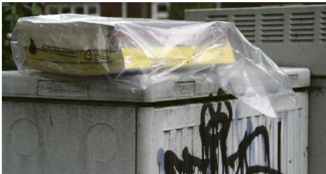
Schaltkästen der Telekom werden häufig Opfer von Anschlägen. Nicht benötigte Telefonbücher oder Zeitungen gehören ins Altpapier, nicht wie hier samt Plastiktüte achtlos liegen gelassen. Foto: mkmedien.de
